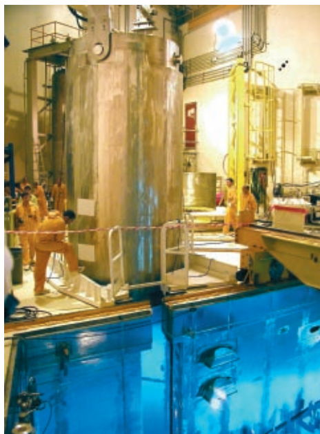
Almacenamiento en seco de combustible gastado en la central nuclear de Trillo.
